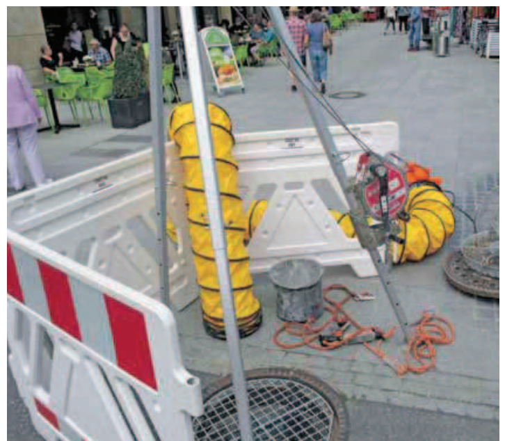
Von außen kaum sichtbar: Hier werden Grundwasserströme beobachtet
