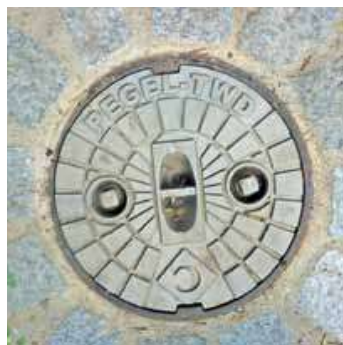
Die Schachtabdeckung einer Grundwasser-Messstelle an der Oberfläche
